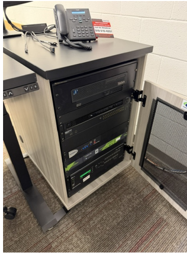
Front door open for AV equipment access
